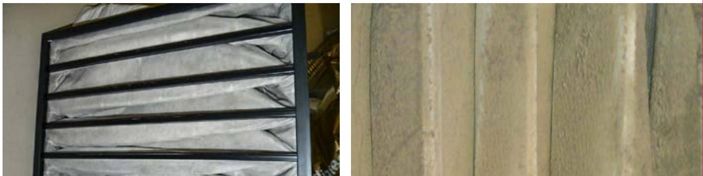
links: Verschmutzter Filter; rechts: Luftfilter stark verstaubt
