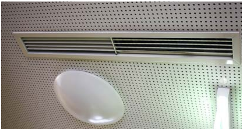
Die Abluft wird hier über Lüftungsschlitze in der Decke abgesaugt
