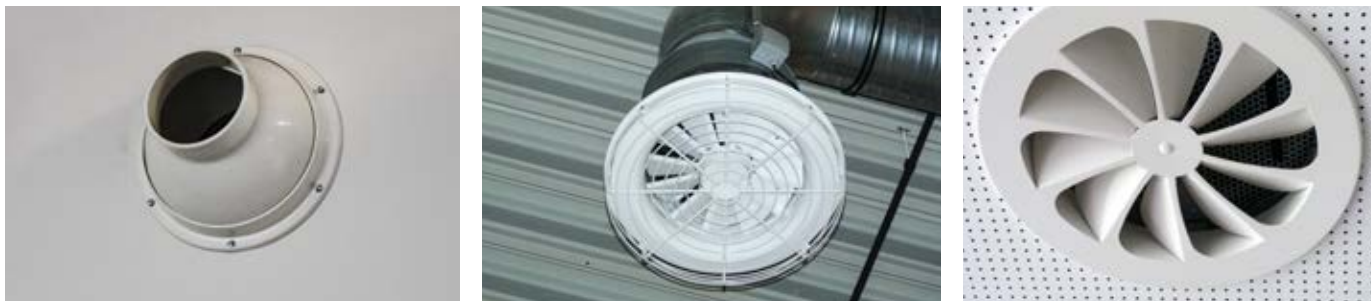
links: Zuluftdüse / Unterrichtsraum; Mitte: Zuluftdüse / Sporthalle; rechts: Weitwurfdüse / Mensa
