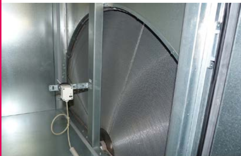
Blick in eine Lüftungsanlage mit Rotationswärmetauscher
