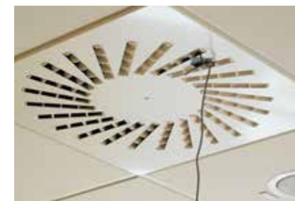
Durch den am Luftauslass befestigten Messfühler können Zulufttemperaturen erfasst und ausgewertet werden.
