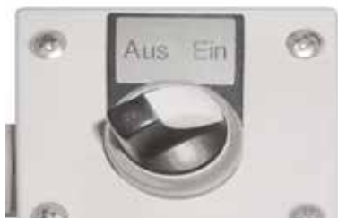
Drehschalter für Abschalten der Lüftung
