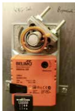
Klappensteuerung auf Bypass, WRG geschlossen.
