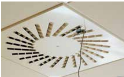
Durch den Messfühler am Luftauslass wird die Zulufttemperatur gemessen
