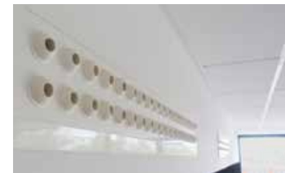
Lüftungsdüsen erzeugen Strömungsgeräusche, die nicht zwangsläufig durch technische Mängel verursacht sein müssen
