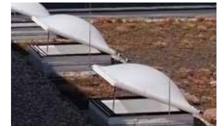
Dachluken werden zum Abtransport der Wärme genutzt
